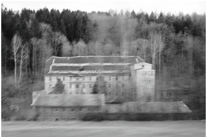
Abb. 30 (unten) Spinnerei Venusberg I fiel als erstes Gebäude zum Opfer der Leerstands und weist nun akute Bauschäden auf.
